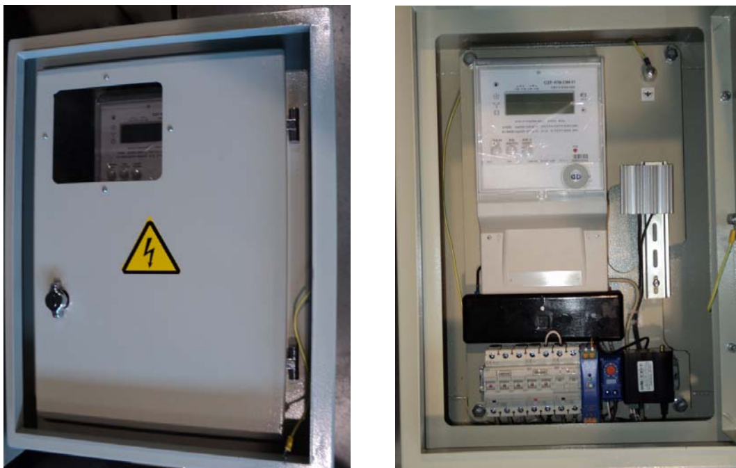
Рис. 7 Внешний вид шкафа учета
